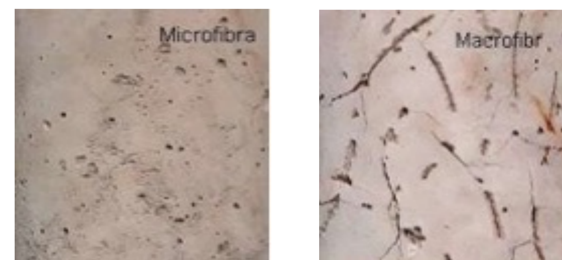
Figura 3: Aspecto superficial de probetas con micro y macrofibras expuestas a 700 °C. Las microfibras al incorporarse en mayor numero resultan más eficientes en el alivio de presión de vapor. Las fibras poliméricas alteran los cambios en la microestructura del hormigón a alta temperatura.
