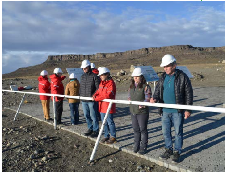
La inspección de obra es realizada por un equipo de ingenieros y participan profesionales de otras disciplinas de la UNLP.
